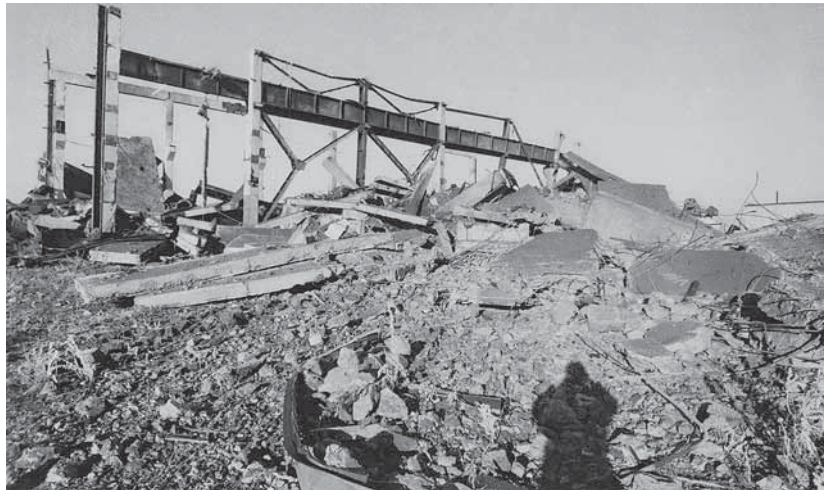
▲ Рис. 2. Здание вентиляторной установки после взрыва
