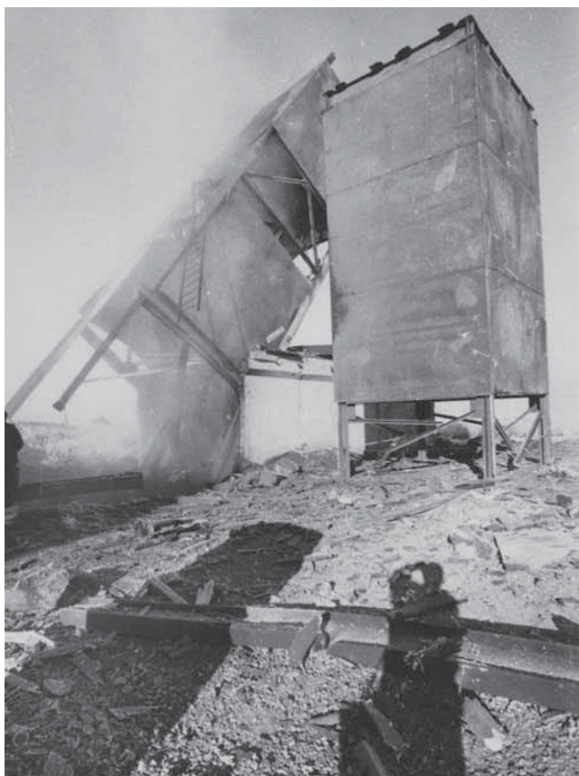
▲ Рис. 3. Разрушенное здание копра
