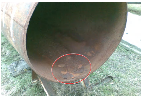
Рис. 1. Коррозионные повреждения внутренней поверхности газопровода
