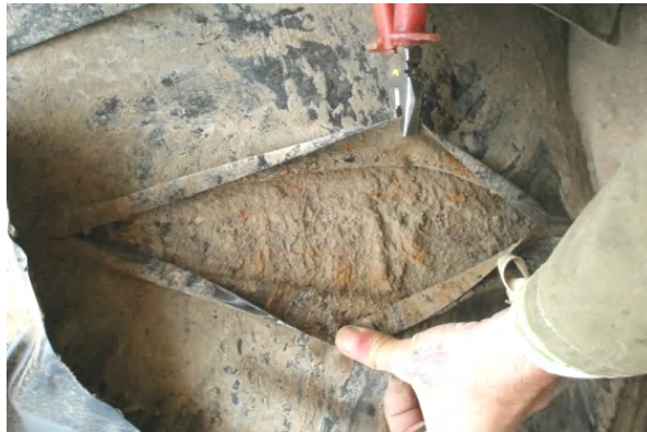
Рис. 1. Пример отслоения изоляционного покрытия магистрального трубопровода
