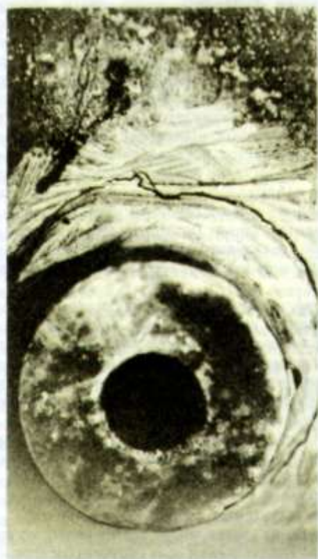
Рис. 3. Трещины в основном и наплавленном металле в районах приварки штуцеров
